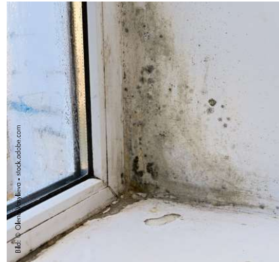
3 | Schimmel in einer Fensterlaibung: Das Risiko, dass er sich bildet, steigt, wenn nur die Fenster ausgetauscht werden und nicht gleichzeitig auch die Außenwand inklusive Laibung gedämmt wird.
